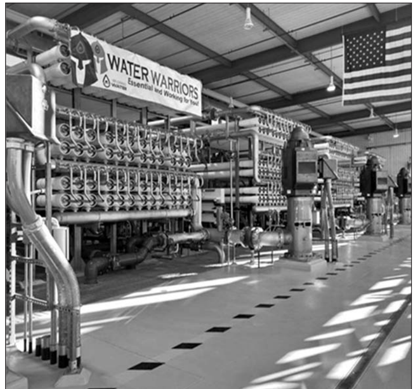
Photo courtesy El Paso Water
